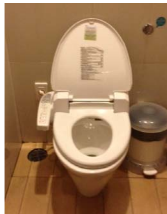
ターミナル 21 デパート内のお尻洗浄トイレ
