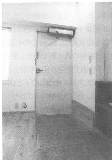
玄関（自動ドアクローザー）
